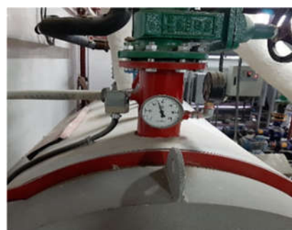
نصب آکوستات دیگ
