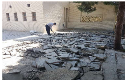
موزاییک محوطه ورودی سلف قبل از تعمیرات
