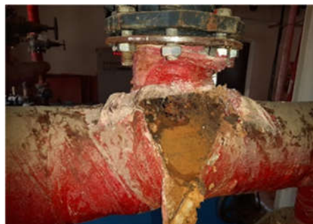
اصلاح و تعویض کلکتور معیوب موتورخانه
