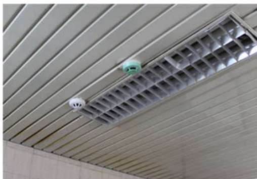
اجرای کامل سیستم اعلام حریق
